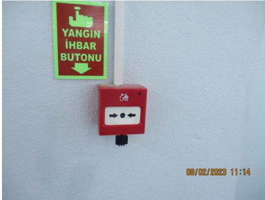
Fire Alarm Button.JPG
